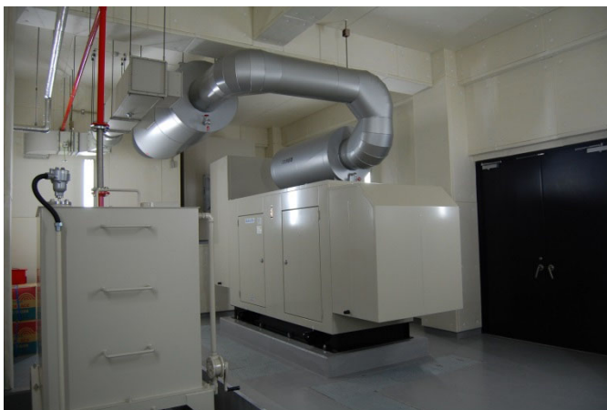
図 5.3.1 非常用発電機（西階水源）
