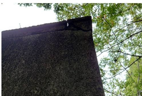
コンクリート構造物の劣化
