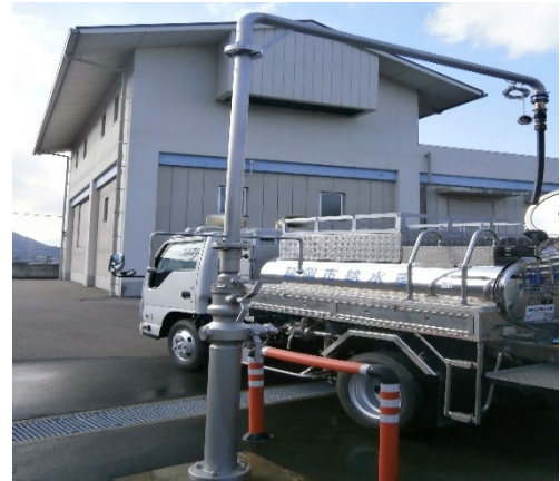
写真 災害時緊急用給水栓
