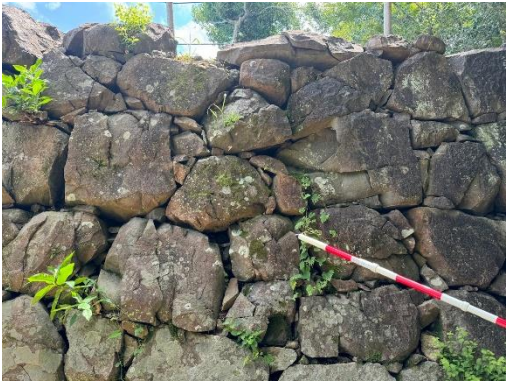
築石が劣化し、亀裂が入る
