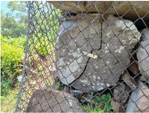
隅角の築石が割れている
