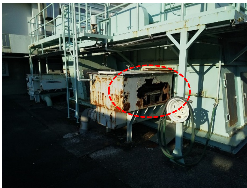
中島町ポンプ場 沈砂池設備 沈砂搬出機の腐食による破損
