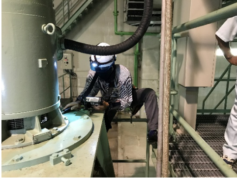
ポンプの振動測定状況
