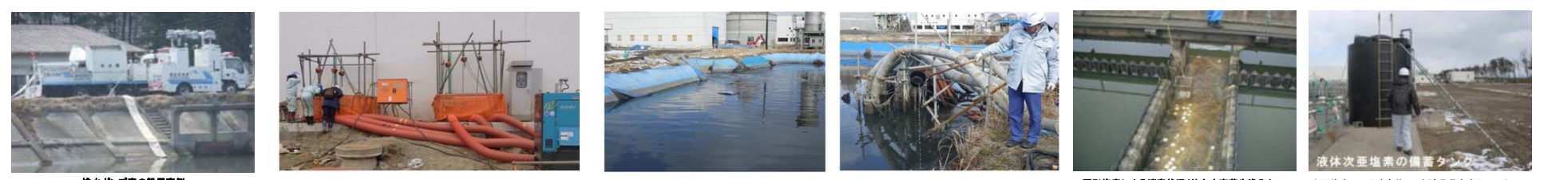
排水ポンプ車の設置事例 (出典:「下水道BPC策定マニュアル 第2版(地震・津波編) 平成24年3月 国土交通省水管理・国土保全局下水道部100ページより) 仮設ポンプの設置事例(宮城県石巻東部浄化センター) 仮設沈殿池の設置事例(宮城県南浄化センター) 固形塩素による消毒状況(仙台南浄化センター) 次亜塩素による消毒状況(宮城県南浄化センター) 液体次亜塩素の備蓄タンク
