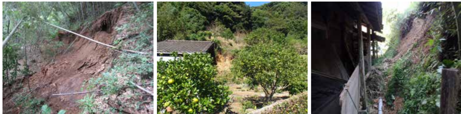
平成 29 年 9 月台風 18 号によるがけ崩れ [上三輪地区] 平成 29 年 10 月台風 22 号によるがけ崩れ [土々呂町土々呂 5 丁目] 平成 30 年 9 月台風 24 号による斜面崩壊 [平田町平田地区]
