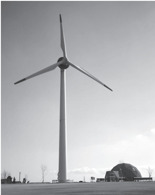
「ETOランド速日の峰」の風力発電施設
