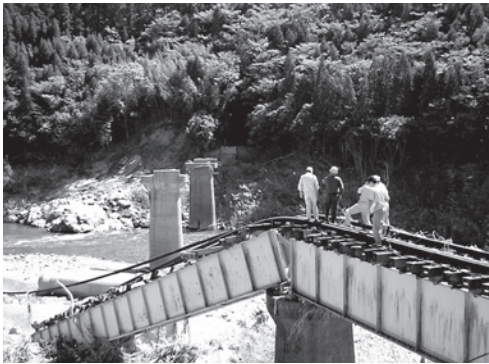
流出した第二五ヶ瀬川橋梁
