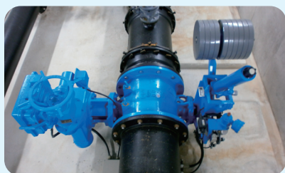
緊急遮断弁設置状況
