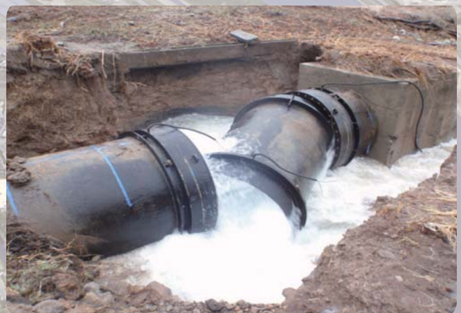
地震による継手部抜け出し被害
