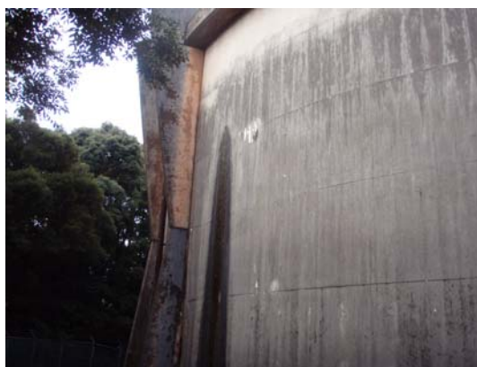
写真 5-7 配水池側壁からの漏水状況
