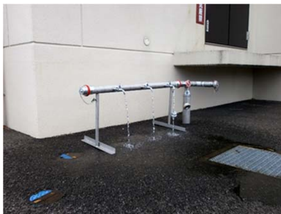
写真 2-3 災害用緊急給水栓
