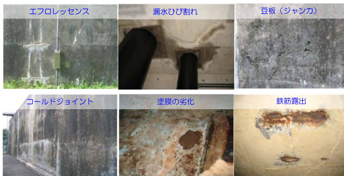
写真 2-1 代表的な劣化現象
