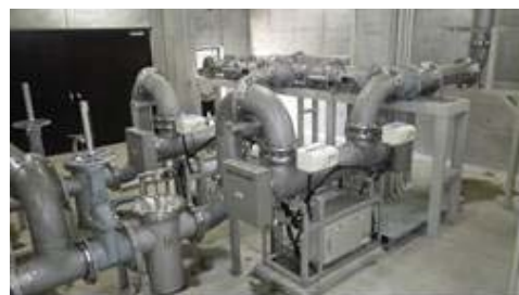
写真 2-2 紫外線処理装置
