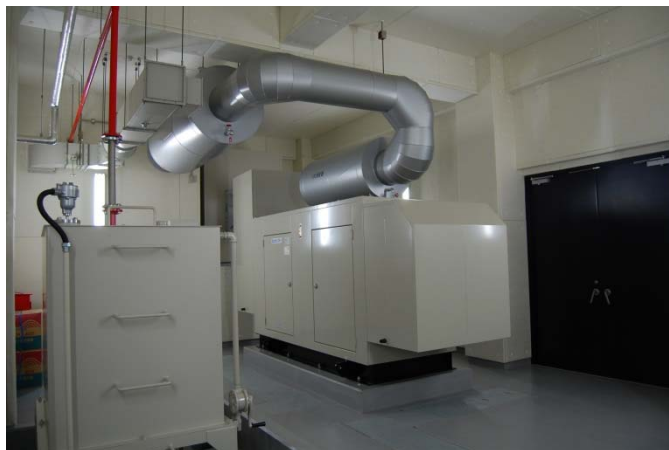
写真 5-2 非常用発電機（西階水源）
