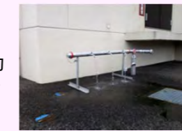
災害用緊急給水栓
