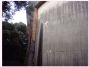
配水池側壁からの漏水状況
