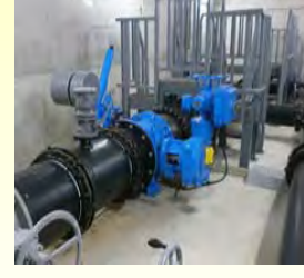
写真：緊急遮断弁
