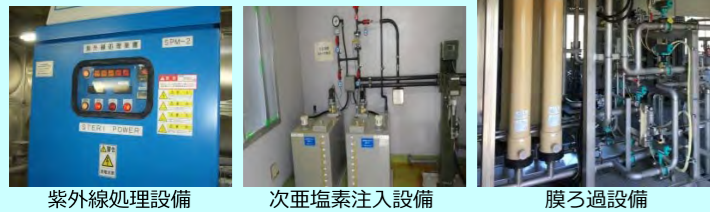
紫外線処理設備 次亜塩素素注入設備 膜ろ過設備
