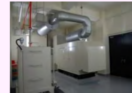
非常用発電機(西階水源)
