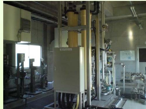
写真 1.2 膜ろ過設備 (須美江水源地)
