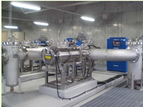
写真 1.1 紫外線設備 (三輪水源地)
