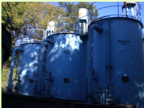
写真 1.3 急速ろ過設備 (荒平浄水場(下北方))
