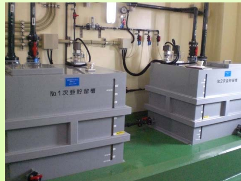
写真 1.4 消毒設備 (西階水源地)
