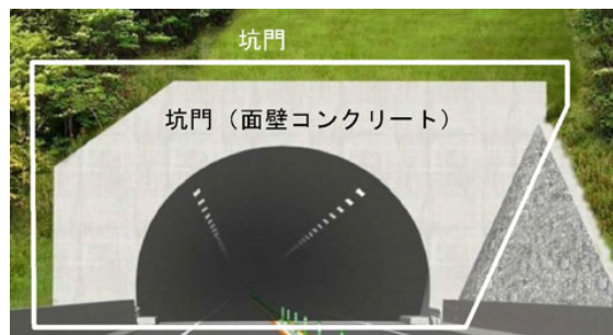
参考：道路トンネル定期点検要領，令和6年9月，国土交通省道路局より 図 1.2 点検対象
