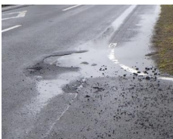
道路の段差や陥没
