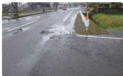
道路の段差や陥没
