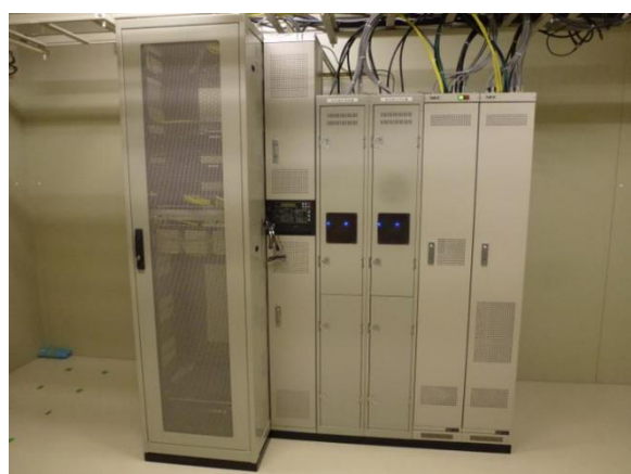
各中継局の無線設備
