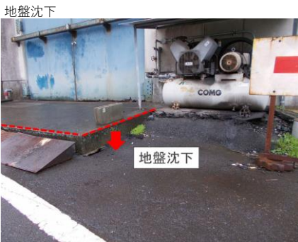
【粗大ごみ処理施設の老朽化の状況】
