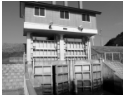
▲フラップゲート (川島町)
