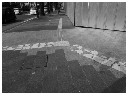
老朽化した点字ブロック
