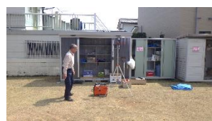
【発電機操作説明】
