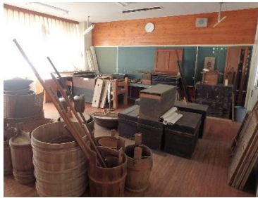
・ 2階普通教室：床材の劣化
