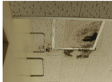
・ 3階階段室：漏水跡
