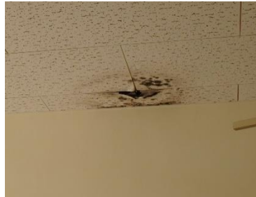
・ 3階旧家庭科室：漏水跡
