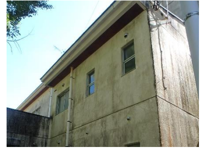
・ 外壁：黒ずみ、汚れ
