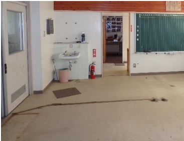
・ 1階旧職員室：床材の劣化
