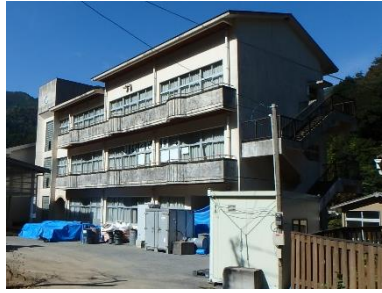
・ 外壁：黒ずみ、塗装の劣化
