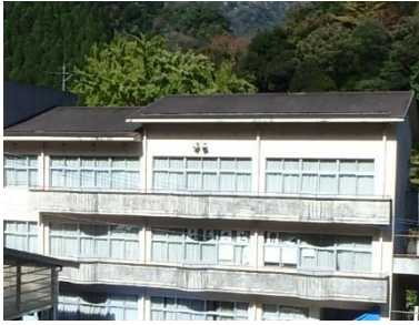
・ 傾斜屋根：塗装の劣化
