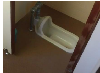
・ 1・2階トイレ：洋式化が望ましい
