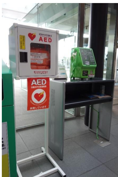
【写真】AEDの設置例（本庁 正面玄関横）
