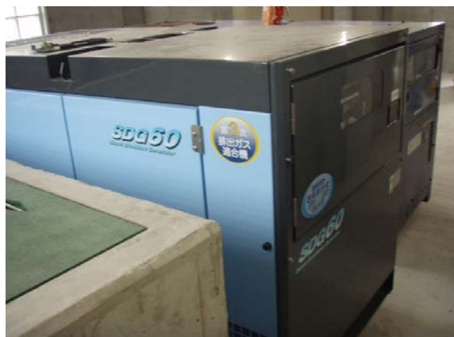
可搬式発電機 SDG60 1台
