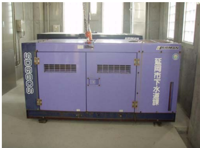
可搬式発電機 SDG60S 1台
