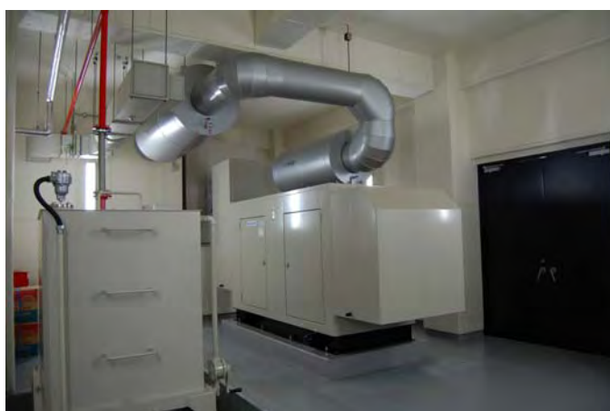
(西階水源地非常用発電機)
