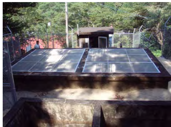
屋形原浄水場
